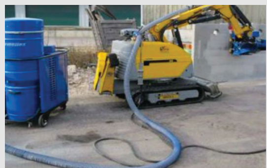
Rabotage / perçage avec système robotisé équipé d'une aspiration à la source THE
